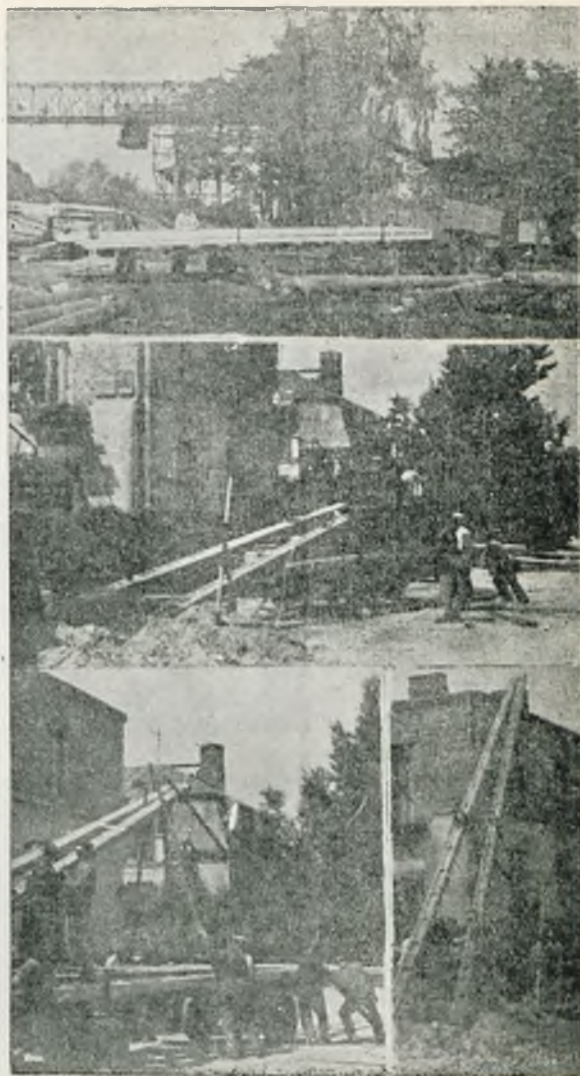
Poszczególne fazy ustawiania masztu „Ala”. Jeden pojedynczy maszt wytrzymuje nacisk 150 kg. „zdublowany” do 750 kg.
