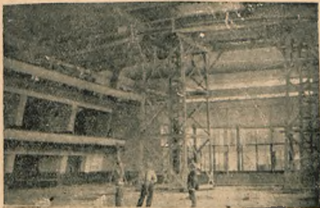
Fig. 1. Rusztowanie przesuwne zastosowane przez firmę St. Gawryczyński przy remoncie II tryb. na Wyścigach na Służewcu.
