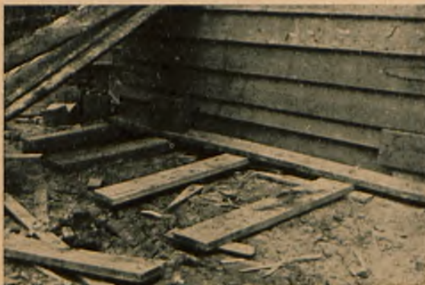
Fig. 1. Podłoga szopy na wapno palone ułożona w pośpiechu na legarach z desek na płask nie zabezpieczyła dostatecznie wapna, przed zamoknięciem podczas dużej ulewy.
