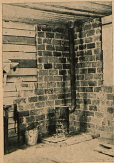
Fig. 4. Prawidłowo ustawiony piecyk żelazny w drewnianym baraku na budowie. Piecyk stoi na „posadzce” z cegiel na płask, ułożonych w ramie z listew. Szczeliny między cegłami wypełnione chudą zaprawą wapienną. Ściany obok piecyka zabezpieczone przed zatleniem ścianką z cegiel na rąb. Blaszana rura kominowa uchodzi w umocowaną w stropie rurę kamionkową (fig. 5), która wystaje ze stropu na około 20 cm. Obok piecyka nie leżą odpadki, śmiecie lub t. p. materiały, jak to się nieraz widuje na budowach, które mogłyby łatwo zająć się ogniem. Paliwo znajduje się w stojącym obok piecyka kubelku. Pogrzebacz i szufelka wiszą w porządku na ścianie.
