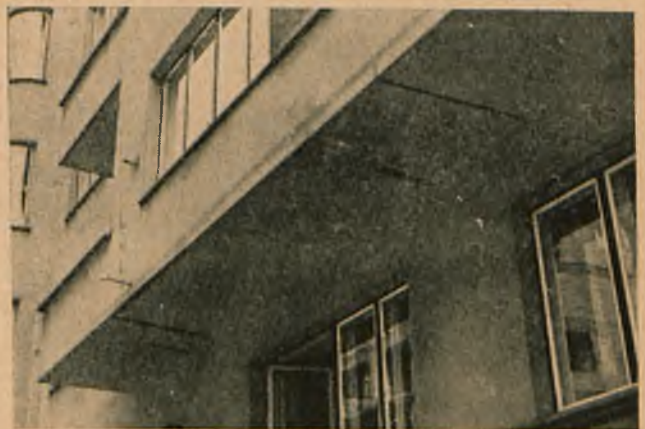
Fig. 2. Dom szkieletowy żelbet. o wykuszu na wspornikach samodzielnych. Widać spękania (zatarte) wyprawy na granicy żelbetu i muru.
