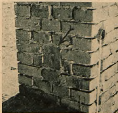
Fig. 4. Zbyt mały sześciak betonowy z klockiem wymaga kłopotliwego omurowania kawałkami cegieł.
