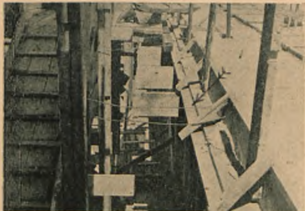
Umocowanie rusztowania przy pomocy specjalnie zabetonowanych w stropie żelbetowym budynku prętów żelaznych (strzałka). W przerwie między rusztowaniem a budynkiem widać deski rozpierające, zapewniające odpowiedni odstęp rusztowania od budynku. Zdjęcie z jednej z budów F-my B-cia Rzeczkowski, Warszawa.
