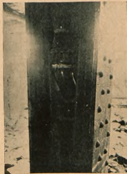
Rys. 10a. Przejście pionu kanalizacyjnego przez słup stalowy ramowy.
