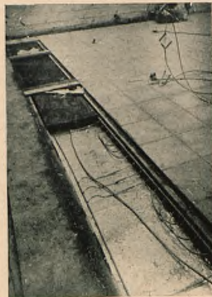
Rys. 12c. Kanal rozdzielczy do podłogi grzewczej (fot. inż. arch. Fischera).
