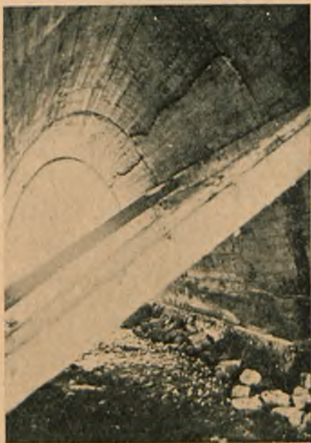
Rys. 2. Załamany i podstemplowany przepust z rys. 1.
