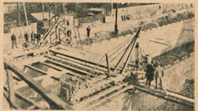
Fig. 1. Układanie gotowych belek żelbetowych przekrywających koryto rzeki przy pomocy dwóch dźwigów na szynach.
