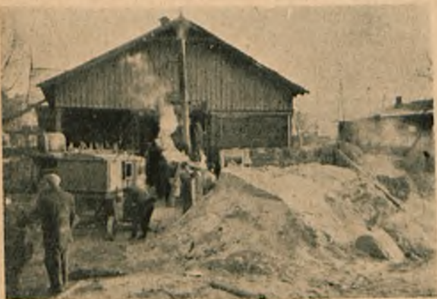
Fig. 8. Widok na maszyny pomocnicze: na pierwszym planie z lewej maszyna do podgrzewania powietrza syst. „Deuba”, dalej lokomobila dostarczająca parę. Na pierwszym planie z prawej, widać zbrzydlony wskutek zmarznięta piasek do betonowania z lewej strony na skraju zdjęcia robotnik grzeje ręce przy piecyku koksowym: mróz był siarczysty!
