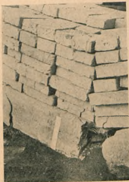
Rys. 7. Miejsce zalamania elementu II.
