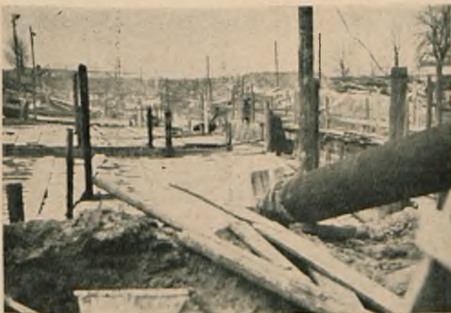
Fig. 2. Widok cieplaka. Na pierwszym planie rura doprowadzająca gorące powietrze.
