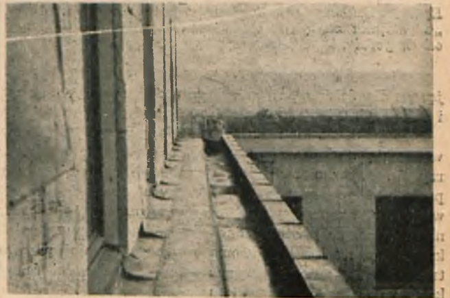
Rys. 9. Dach żelbetowy traktu „I”. Widoczna ściana kollankowa nad rynną, pokryta blachą miedzianą.
