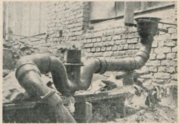
Rys. 22. Odwodnienie studzienki podokiennej piwnicznej. Od prawej do lewej: kratka spustowa bezsyfonowa, syfon ocieplony zasypem z otworem rewizyjnym, rura odpływowa do kanalizacji.
