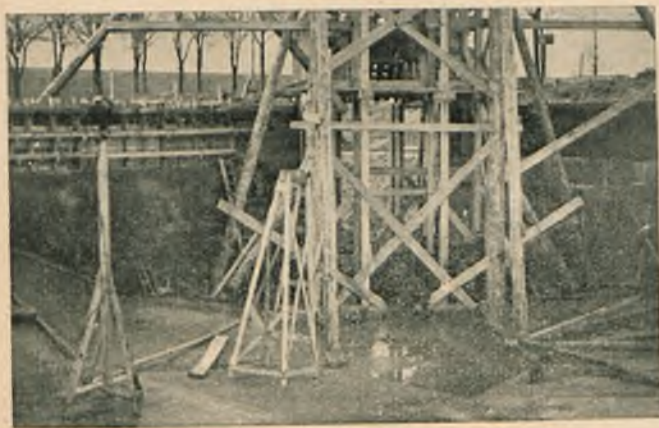
Fot. 2. Dolna część rusztowania wieży — z boków widoczne 5-metrowe żelbetowe ściany basenu do skoków.
