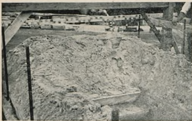
Fot. 11. Próbné obciążenie piaskiem najwyższego podestu na poziomie + 10,00 m ciężarem równym 4500 kg ( 450 \text{ kg/m}^2 ).
