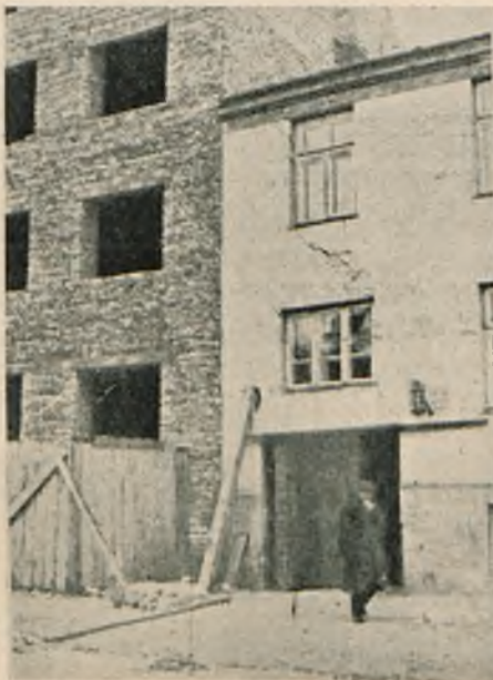
Fot. 4. Osiadanie i rysy tym osiadanem wywołane na ścianie z otworami. Osiadła ściana sąsiadująca z nowobudowanym budynkiem.
