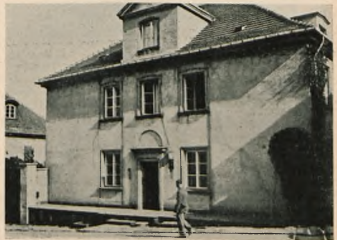
Fot. 6. Pęknięcia budynku spowodowane osuwaniem się terenu.
