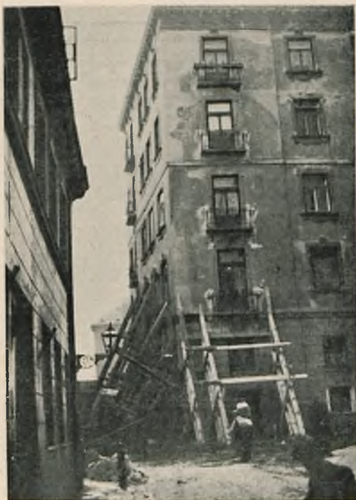
Fot. 7. Zdjęcie ogólne budynku, którego mur fundamentowy pokazano na fot. 2. Prawidłowe podstemplowanie w czasie robót wzmacniających, wykonywanych małymi odcinkami.
