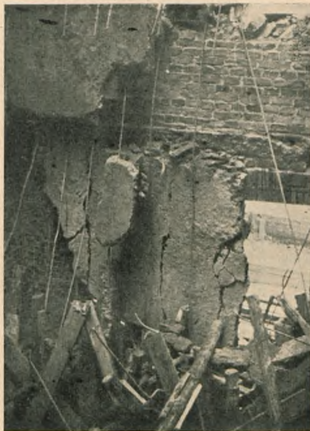
Rys. 31. Zawalenie się 5-ciu stropów na skutek zbyt wczesnego rozszalowania przedostatniego stropu.
