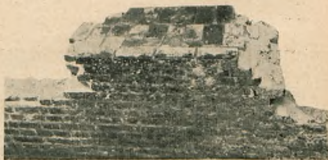
Rys. 32. Niedbale wiązanie cegieł, duża ilość kawałków cegieł, sypiąca się zaprawa, która nie związała z powodu murowania w zimie bez żadnych środków ostrożności.
