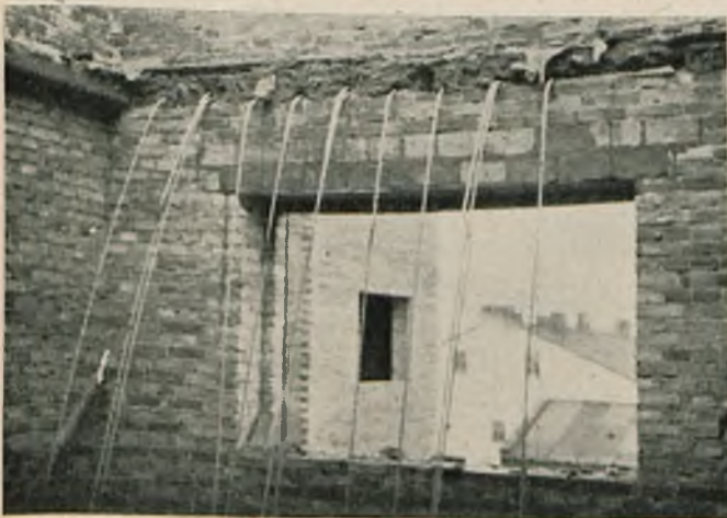
Rys. 27. W zawałonym stropie widzimy górne zbrojenie prawie w tym samym poziomie co dolne.
