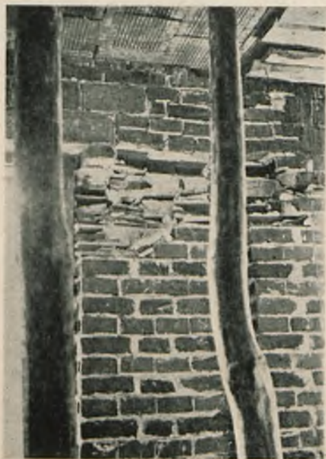
Rys. 23. Zmiażdżenie słabej cegły dziurawki w filarze.
