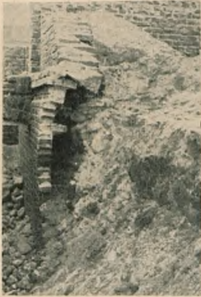
Rys. 20. W piwnicach zamiast ściany 55 cm dano 2 ścianki po 13 cm z wypełnieniem w środku śmieciami i gruzem.
