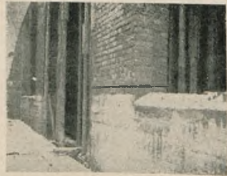
Rys. 29. Ziemia gliniasta wypchnęła stemple do góry, przez co został uniesiony strop a nawet filar mury, który zawisł u góry.
