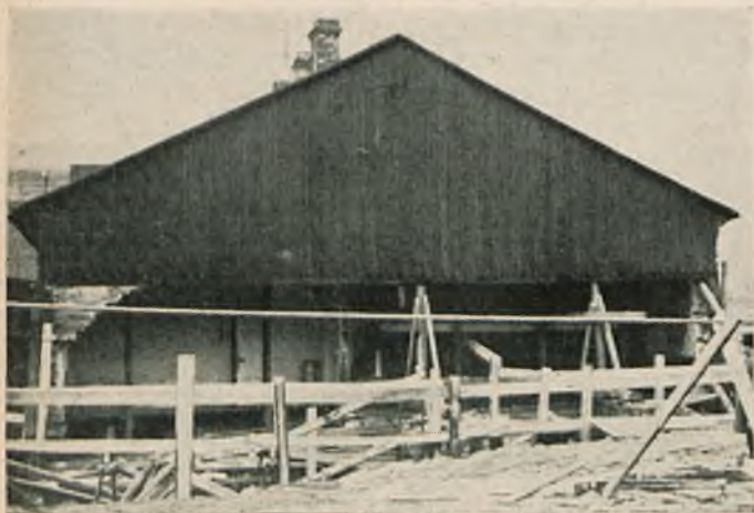
Rys. 35. Zawalenie się ściany na skutek obnażenia przez sąsiada spodu fundamentów.
