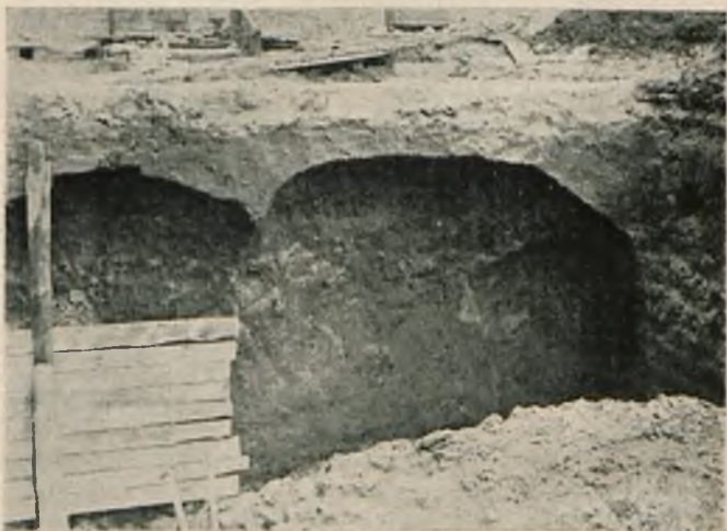
Rys. 25. Oberwanie się ziemi w innej części wykopu wskazanego na rys. 24.
