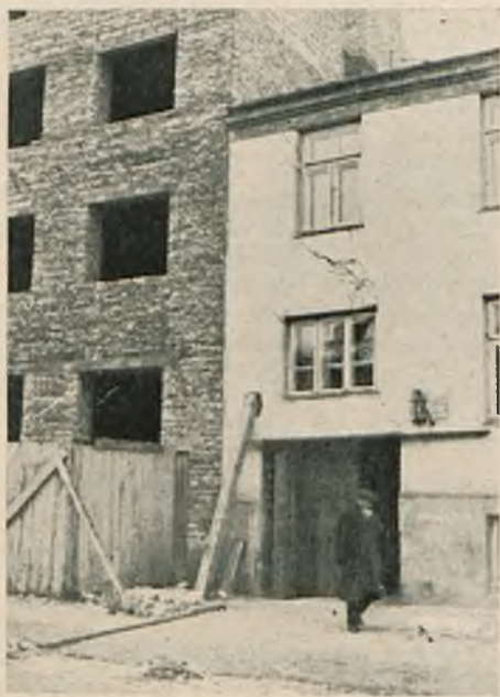
Rys. 36. Charakterystyczne pęknięcia na skutek podkopania fundamentów przy wznoszeniu nowego budynku.
