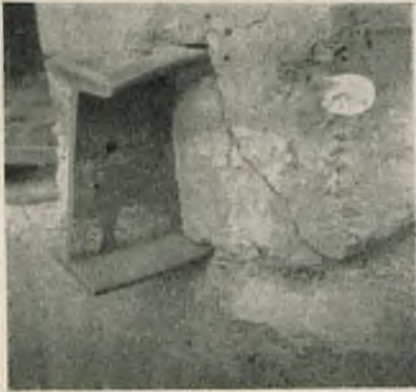
Rys. 26. Skutki niewymycienia śmieci lub śniegu z deski szalowania słupa żelbetowego.
