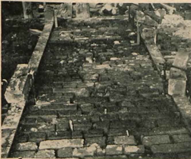
Rys. 34. Złe wykonanie stropu Klema — w znacznej części widać kawałki cegieł.
