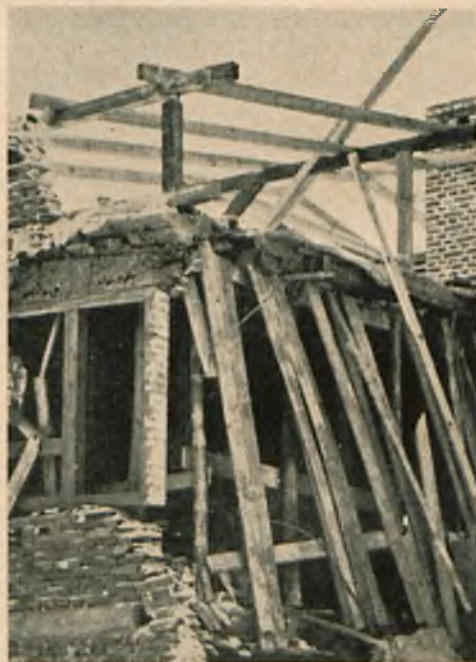
Rys. 19. Zawalenie się domu, gdzie samowolnie zmieniono konstrukcję ścian; zamiast 55 cm z pełnej cegły dano 41 cm ze słabej dziurawki.
