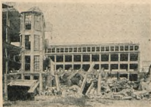
Rys. 15. Zawalona część żelbetowego magazynu w Rydze.
