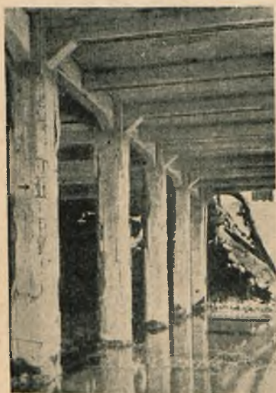
Rys. 17. Zniszczenie podstaw słupów żelbetowych po pożarze na skutek dużych momentów od wydłużeń termicznych.
