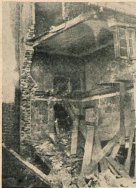
Fot. 1. Widok ogólny zawałonego domu od góry. Strop mansardy trzyma się na ramie futryny okiennej jak na kratownicy.
