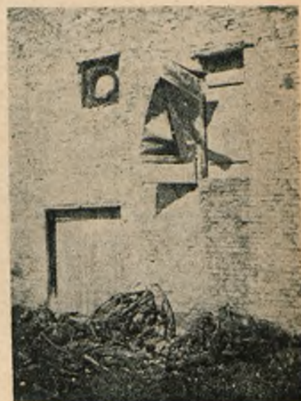
Rys. 18b. Widok po pożarze drzwi drewnianych obitych blachą.
