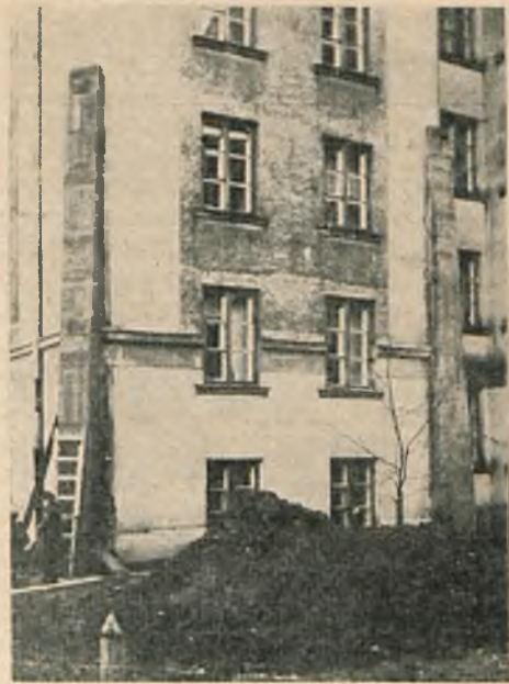
Rys. 4. Fotografia ściany a—c (patrz rys. 1) budynku wzmocnionej skarpami i podmurowanej.
