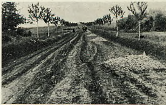
Fot. 3. Zniszczona wiosennymi przetłomami, droga powiatowa Mykietyńce — Podłuże — Pobereże.
