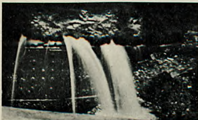
Fot. 11. Woda wypływa z nadmurówki nad kesonem filara Nr 7.
