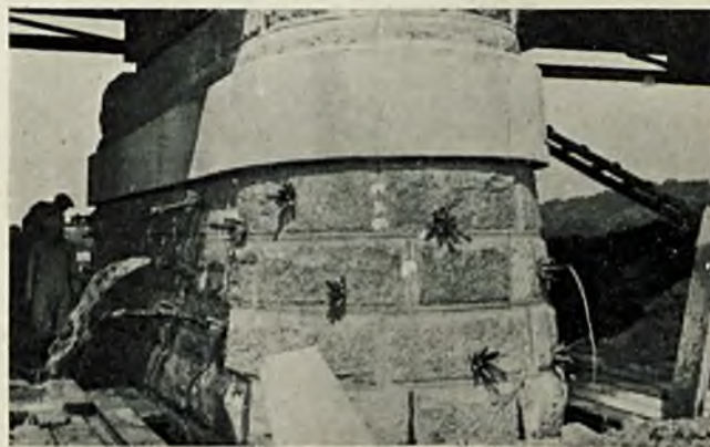
Fot. 7. Płukanie filara. Z sąsiedniego otworu woda idzie zanieczyszczona i w dużej ilości; zupełnie z drugiej strony filara idzie również mały strumyczek. Widać opaskę żelbetową, rury i ich osadzenie w murze, zawory na rurach.
