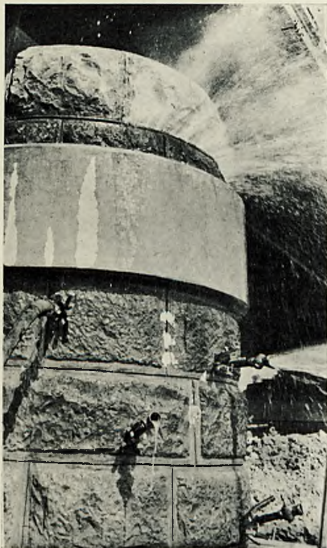
Fot. 8. Płukanie filara. Z najbliższego otworu wychodzi mało wody, z dalszego duża ilość, z fugi nad opaską cały wachlarz. Widać zawory na rurach.
