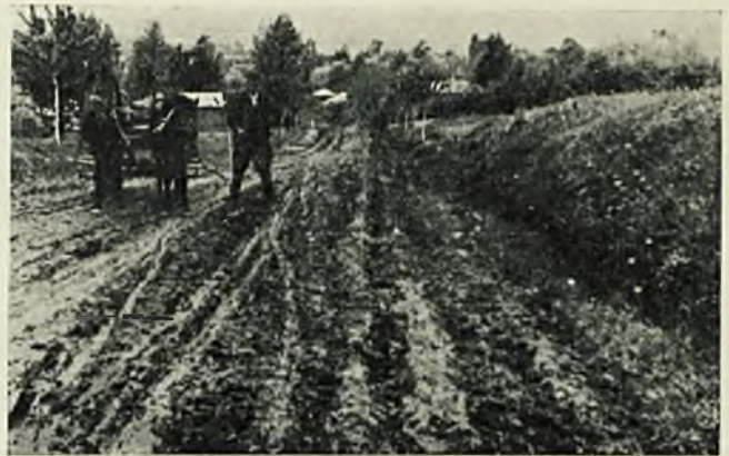
Fot. 4. Zniszczona wiosennymi przetłomami droga powiatowa Mykietyńce — Podłuże — Pobereże.
