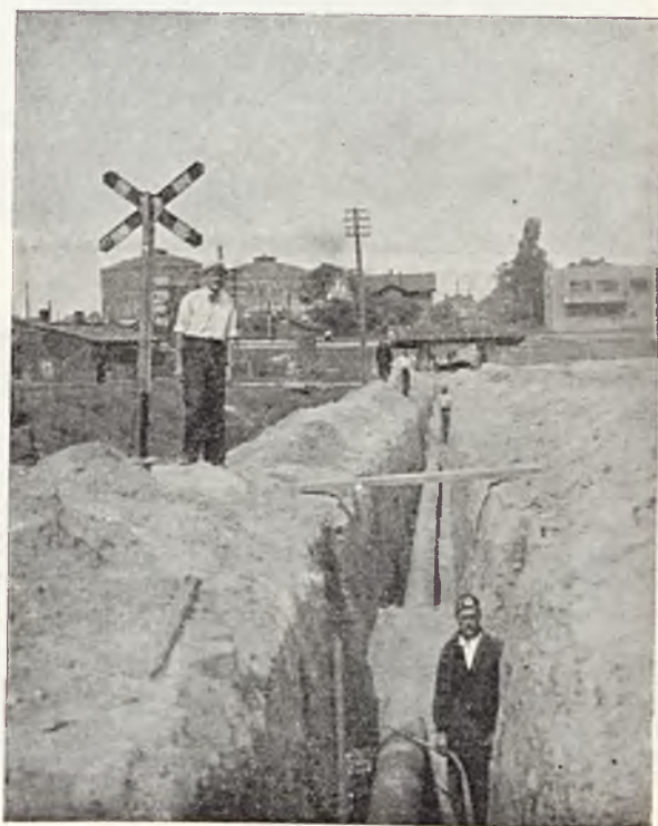
Gazociąg wysokoprężny w Warszawie.
