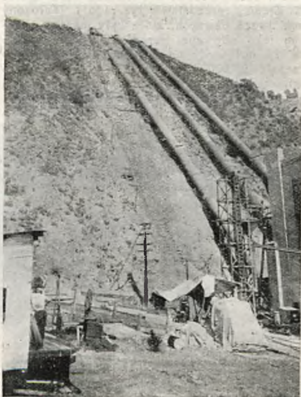
Rys. 158. Rurociąg o średnicy 2 m. doprowadzający wodę do centrali hydroelektrycznej (St. Zjedn.).
