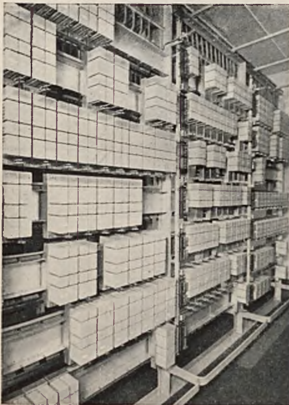
RYS. 15. STOJAKI LINII DALEKOSIĘŻNYCH.
