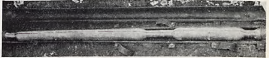
RYS. 9. MIEJSCE REPAROWANE W DWUDZIELNEJ RURZE OCHRONNEJ.
