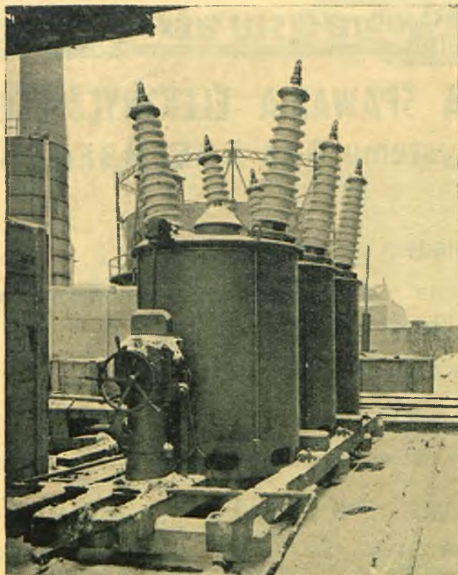
Aparatura wysokiego napięcia do 220 kV.
