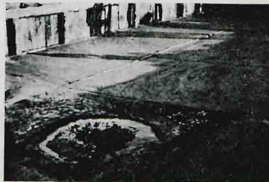
Rys. 5. Śluza w Duboi — głowa dolna — kurzawka przerywa pierwszą warstwę betonu.
