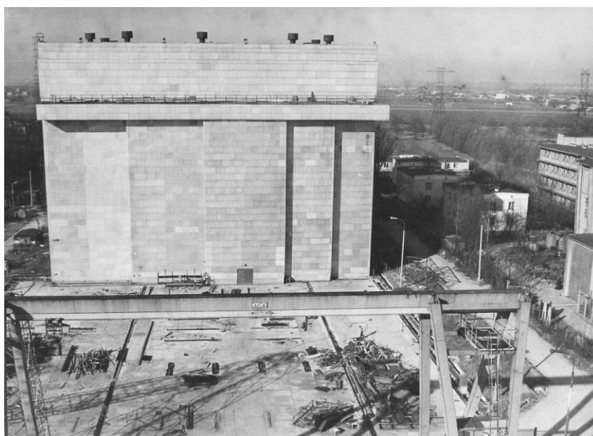
Gotowa do montażu urządzeń Hala Najwyższych Napięć IEn., i fragment Pola Probierczego 400 kV, z suwnicą bramową 5 Ton
