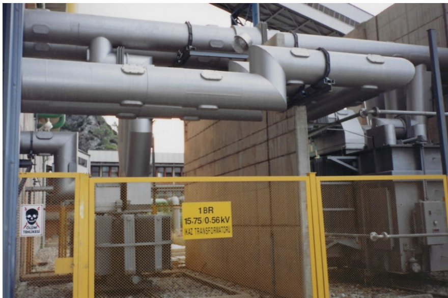
Wyprowadzenie mocy w elektrowni Kemerköy
