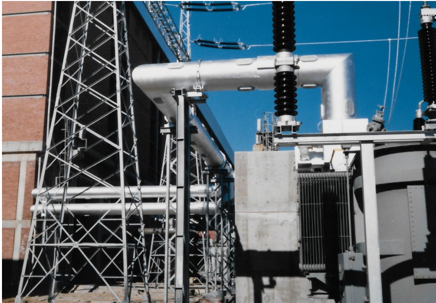
Wyprowadzenie mocy w elektrowni Yeniköy
