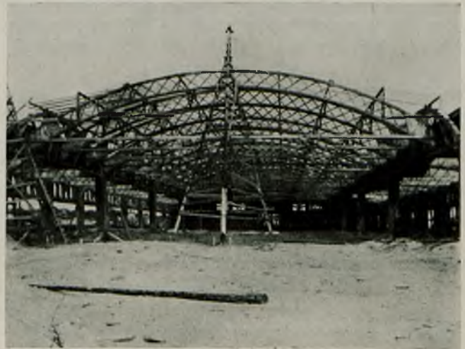
Magazyn bawelniany. Dźwigary dachowe oraz dźwigi do ich podnoszenia; środkowy do dźwigarów 28 m rozpiętości. Z lewej strony — do 24 m.
