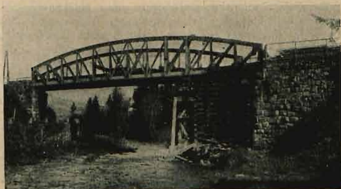
Uszkodzony most przez rz. Sychlę na linii Stryj — Beskid, podchwycony stosami podkładów
