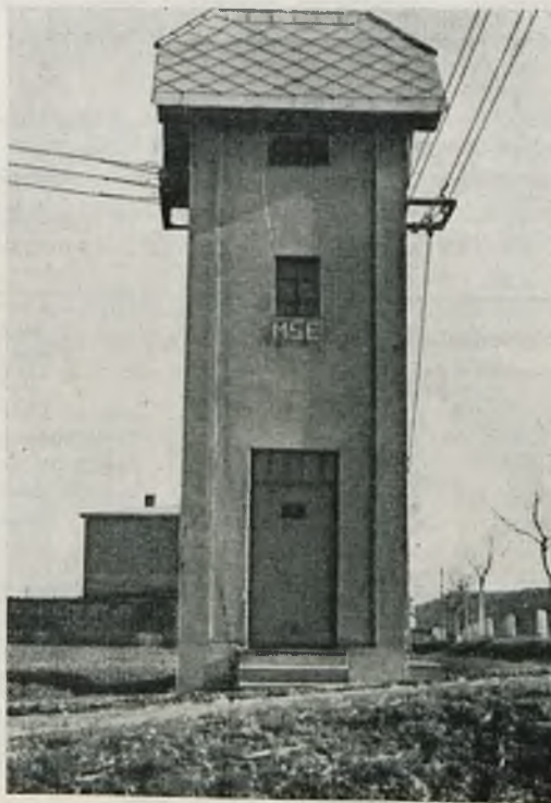
Rys. 4. Typowa stacja transformatorowa.
