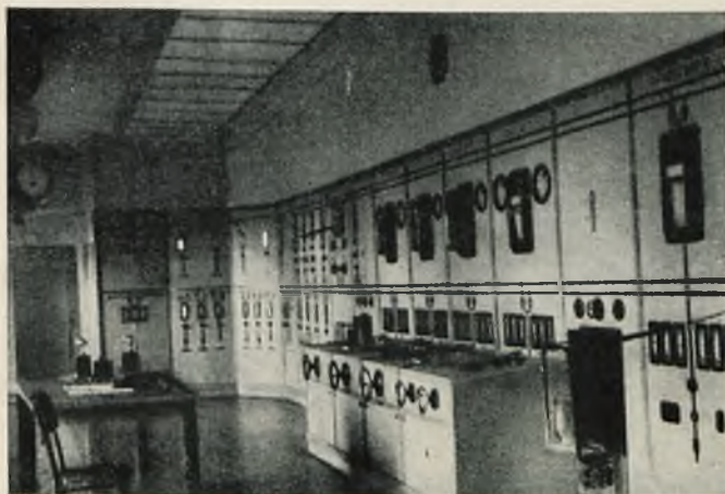
Nastawnia wykonana przez firmę „Elin” dla Elektrowni Okręgu Warszawskiego
