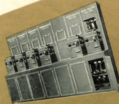
Okapturzon rozdzelnia wy- sokiego napięcia
