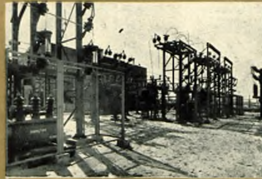
Podstacja napo- wietrzna 35 kV
