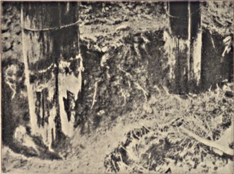
Rys. 2. Słup z przystawką zniszczony przez grzyb domowy. (Według Valaska).
