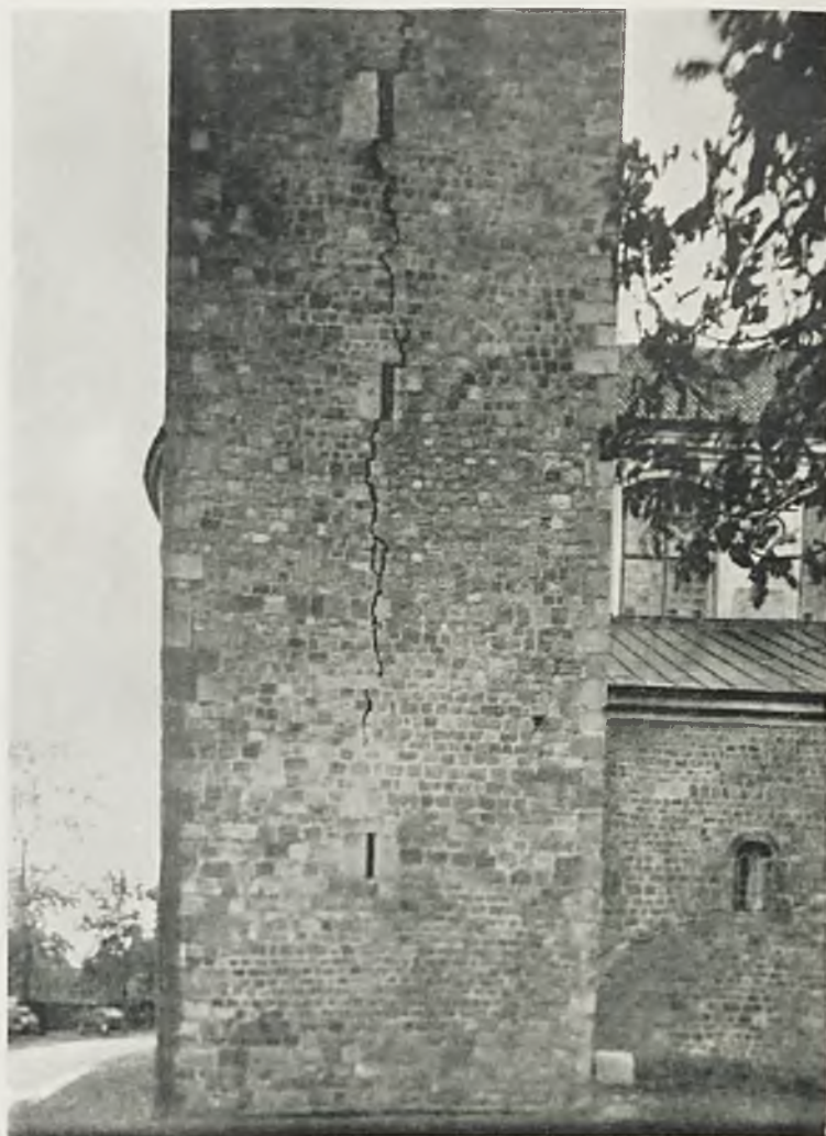
Ryc. 198. Tum pod Łęczycą. Kościół św. Aleksego. Pionowe pęknięcie na wieży południowej.
