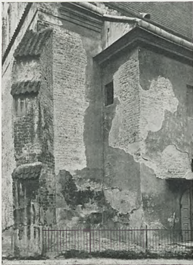
Ryc. 104. Lublin. Kościół N. M. P. Zwycięskiej. Fragment fasady przed odbiciem tynków.
