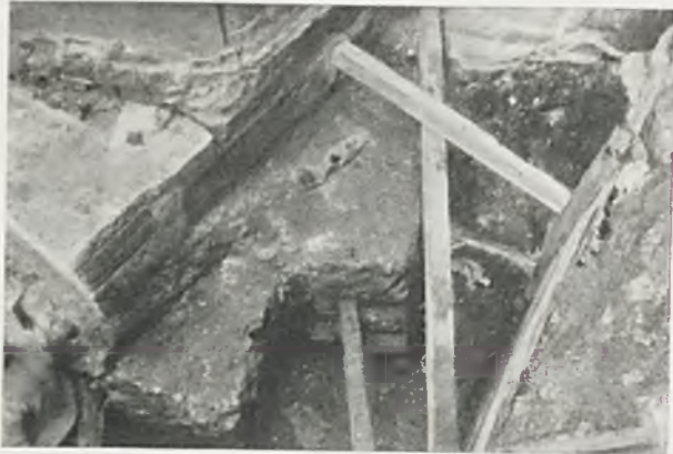
Ryc. 18. Kraków. Kościół N. M. P. Fundament szkarpy nachylony pod 45° od strony południowej.
