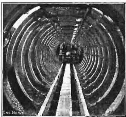
Rys. 1. Widok wózka z przodu w przewodzie rurowym Towarzystwa Elektrycznego.
